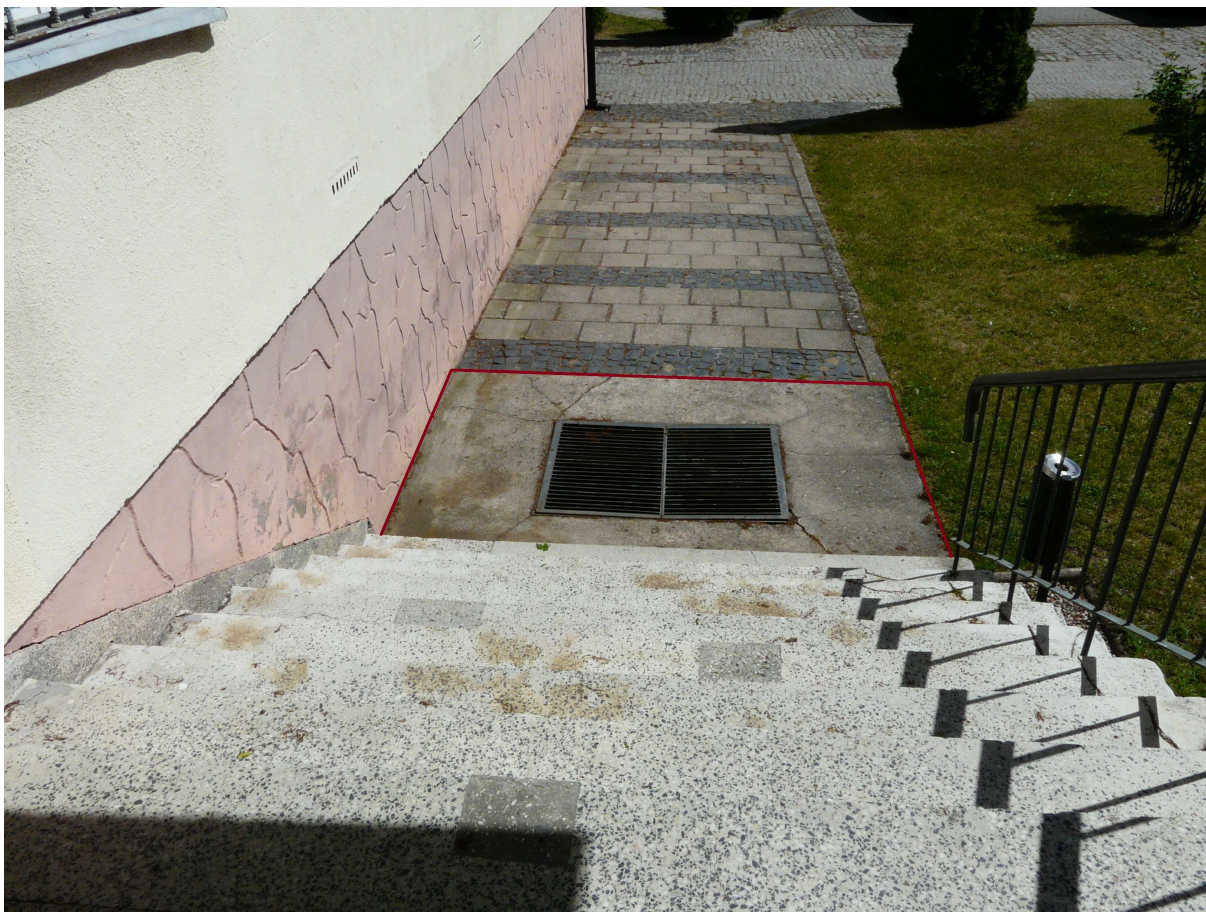
zdj. 2: widok na fragment nawierzchni chodnika przed schodami, przeznaczony do remontu
